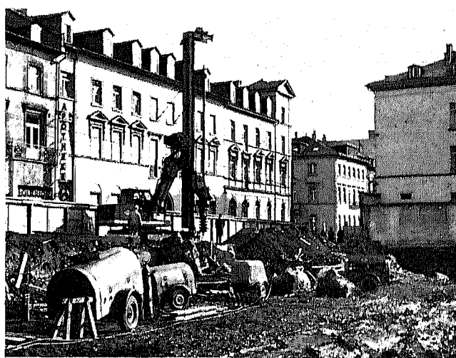
Bild 15. Baggeranbaubohergerät BB 6 der Salzgitter Maschinen AG beim Bohren mit Bohrschnecke für Trägerverbau (Werkfoto: Gebhardt & König) Power shovel attachment drill BB 6 of Salzgitter Maschinen AG during drilling with the aid of an auger for beam-type retaining construction Équipement interchangeable de forage à un excavateur BB 6 de la Salzgitter Maschinen AG en forant avec une hélice de forage pour une construction de soutènement à poutres Trivellatrice da montare su veicolo cingolato BB 6 della Salzgitter Maschinen AG durante la trivellazione con coclea trivellatrice
